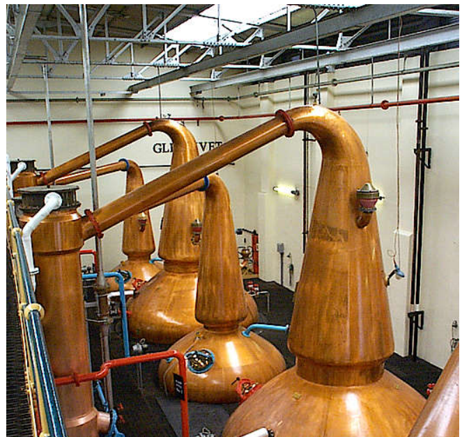
Brennblasen und Kondensatoren
