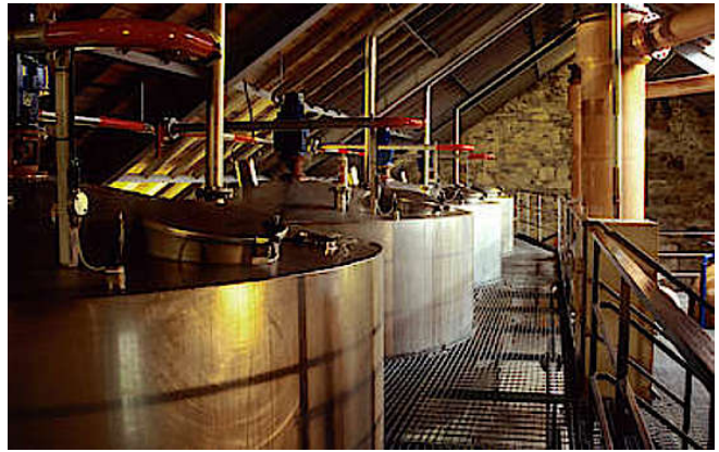
Wash Back und Kondensatoren
